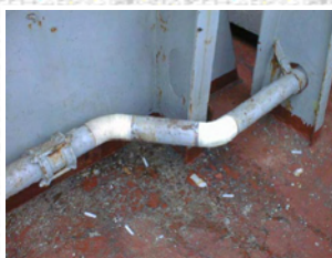
Mit Pipe Tape ausgebesserten Rohren
