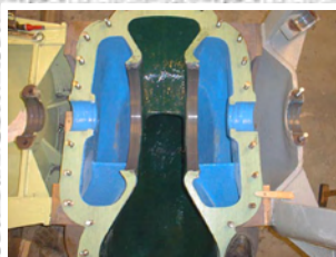
Sitze der Dichtringe einer Pumpe
